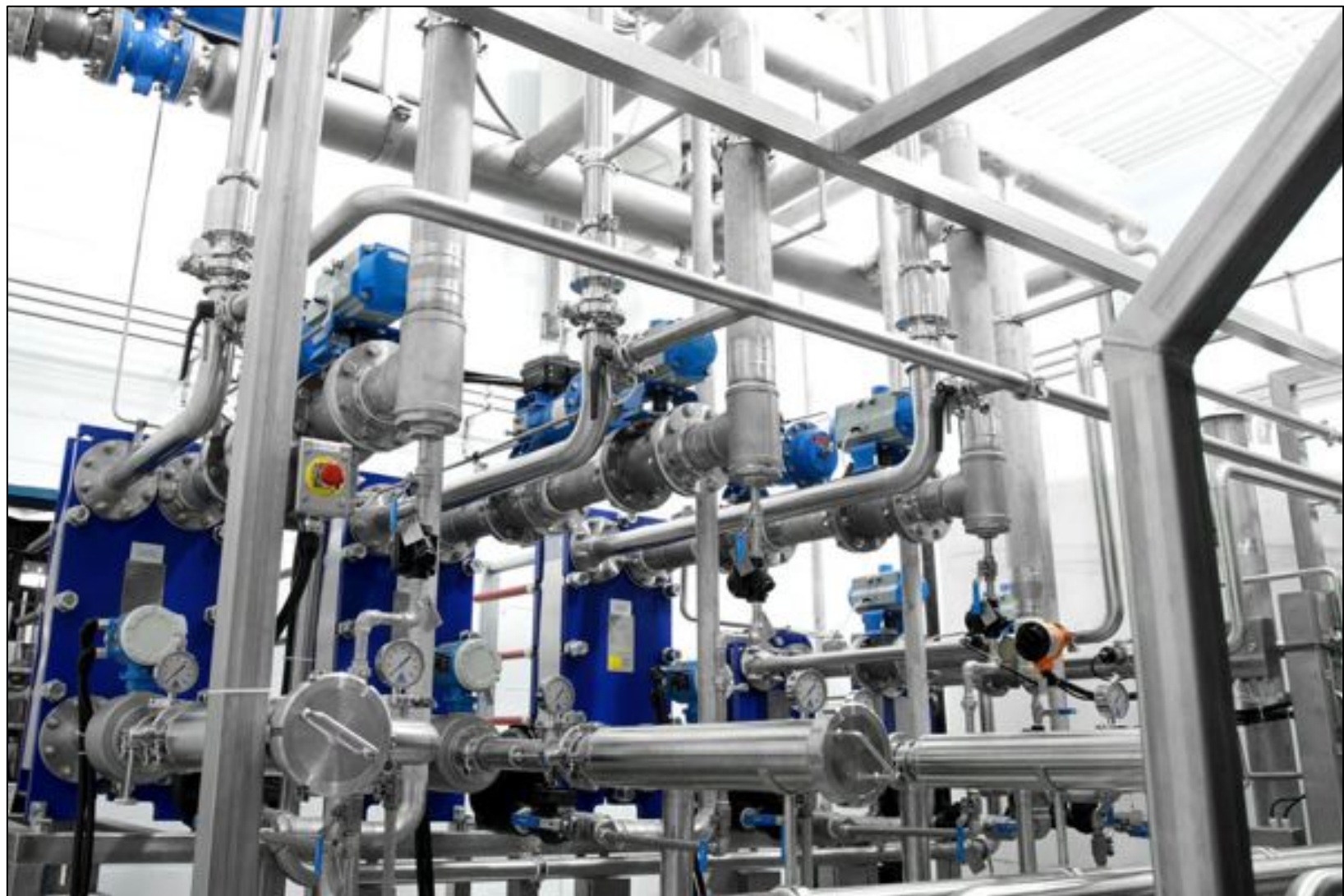
ステンレス配管装置
