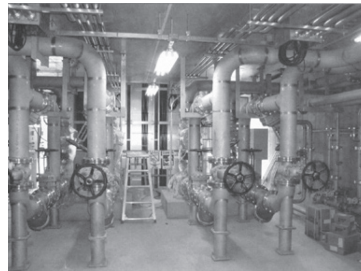
▲浄水場装置配管
