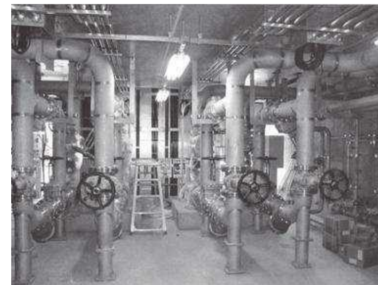
▲浄水場装置配管
