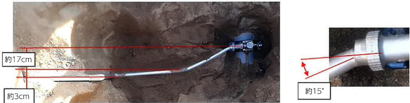
出典：公益財団法人給水工事技術振興財団【給水管分岐部に係る給水配管の耐震性評価報告書18ページ図7-11「サドル付分水栓及び給水管の変形状況」の写真×2枚の掲載】
